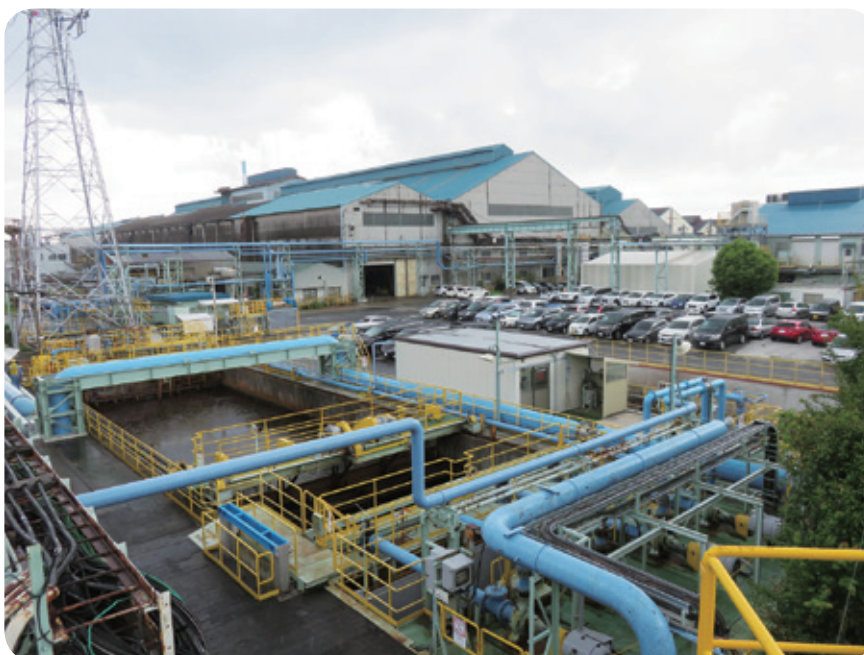
星崎工場排水処理
